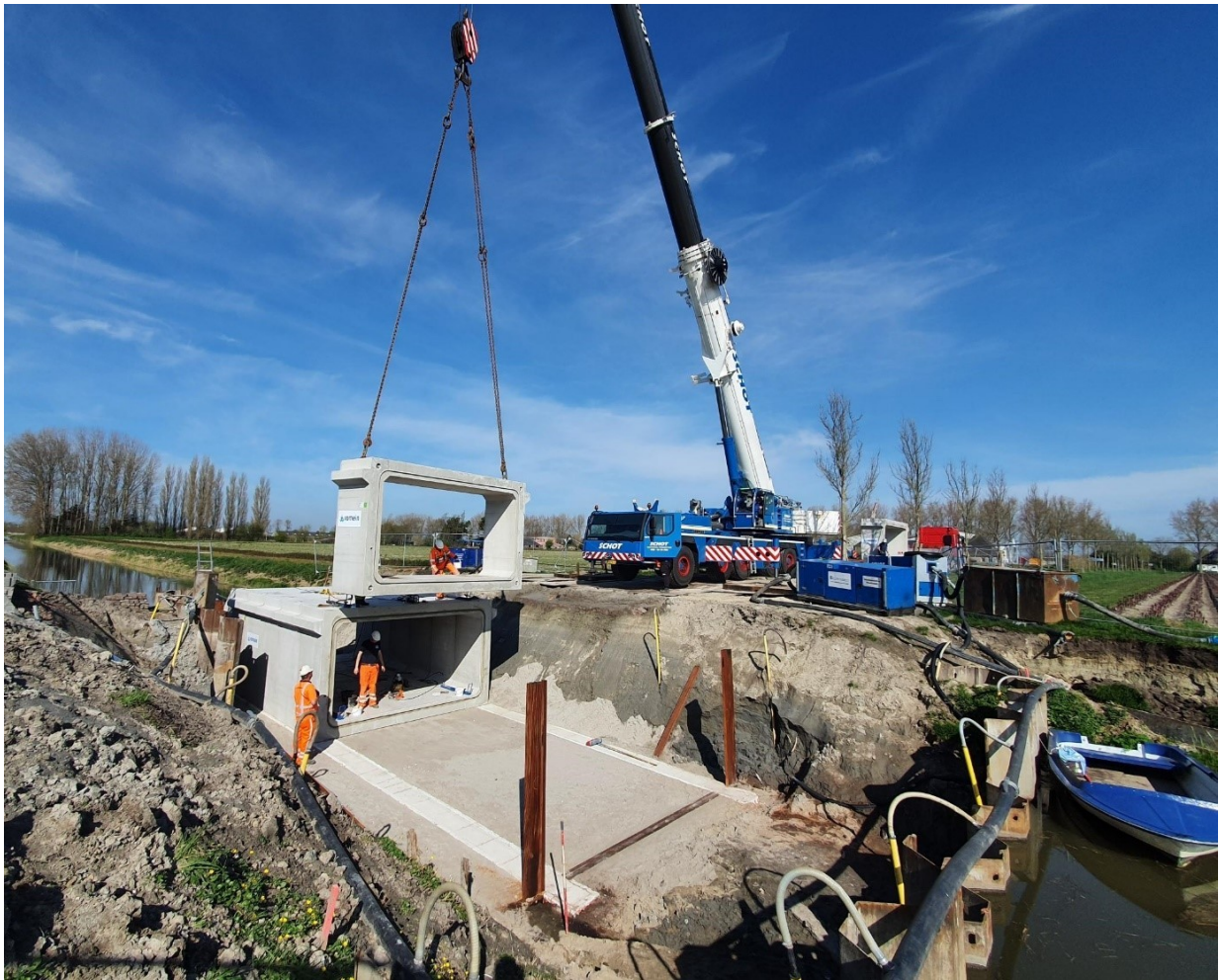
Foto: Plaatsing nieuwe duiker onder de Torenweg ter verbetering van het watersysteem van polder de Drieban
