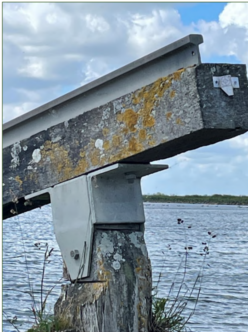
Figuur 1, een van de ijsbrekers: stalen manchets en rail zijn als nieuw
