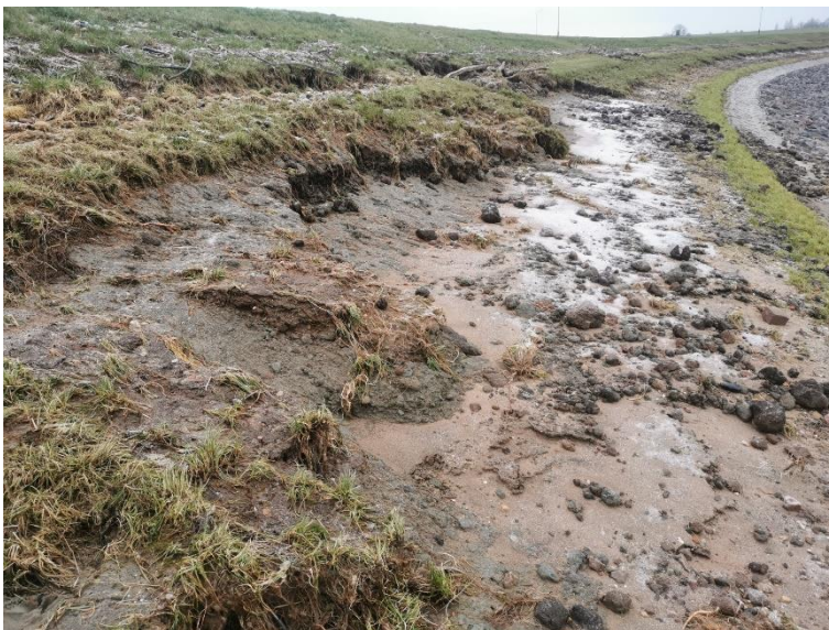
Figuur 3.2. Schade aan bekleding buitentalud van de dijk bij Spijk, die recent versterkt is met gras 1,5 à 2 jaar oud (bron: Waterschap Rijn en IJssel).
