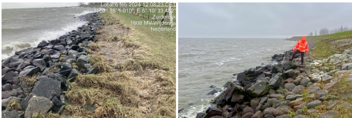
Figuur 3.7 Schade aan bekledingen IJsselmeer en Markermeer (bron: Hoogheemraadschap Hollands Noorderkwartier).
