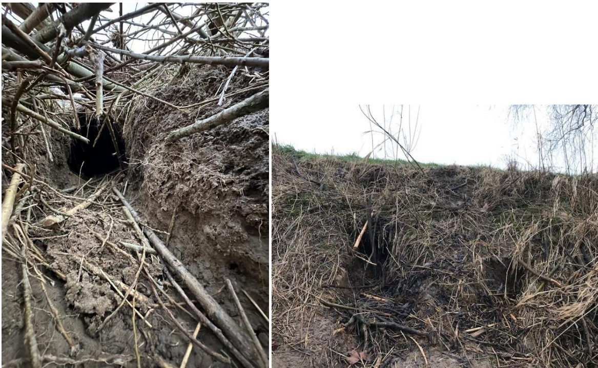
Figuur 3.3 Bevergraverij ontdekt na het zakken van het hoogwater (bron: Waterschap Rivierenland). Links in een oprit, rechts in het buitentalud.
