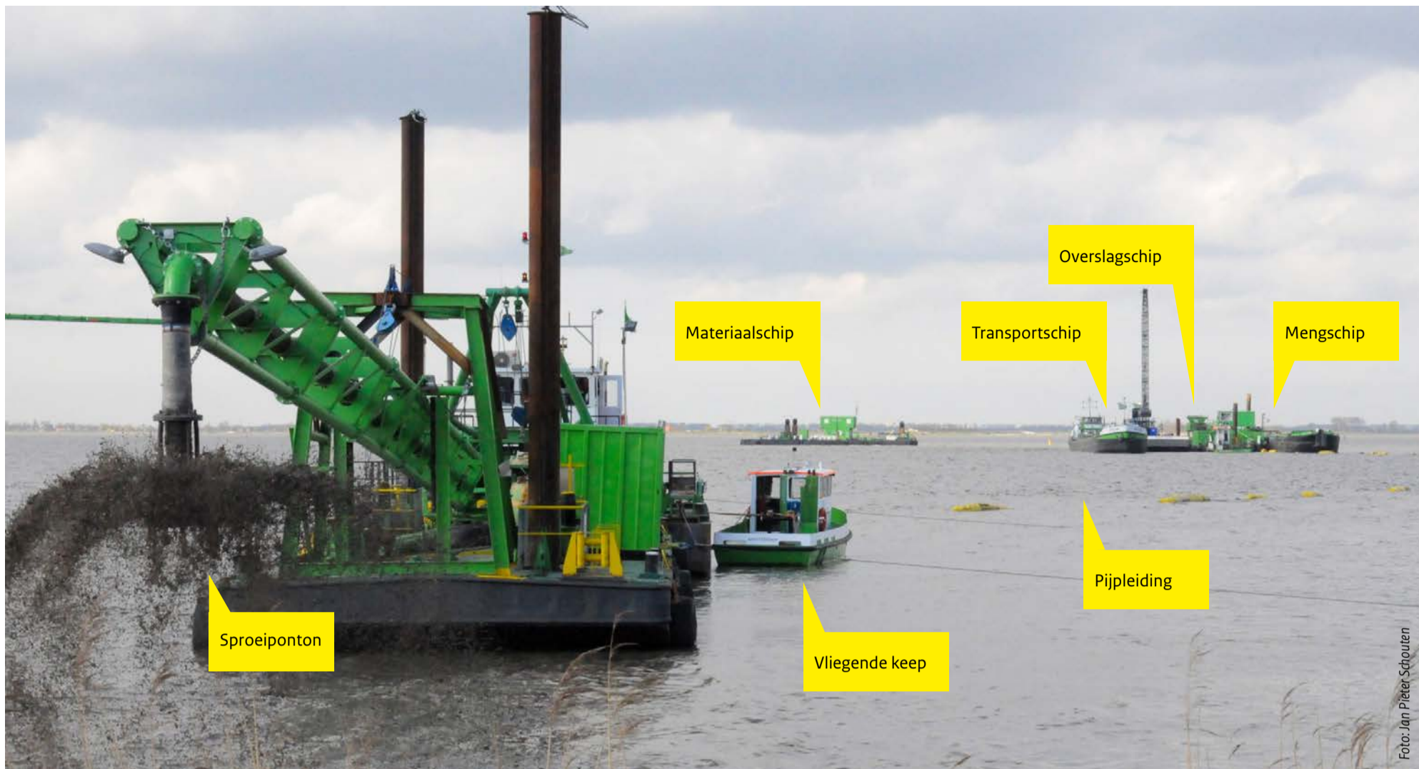
Op de voorgrond de sproeiponton en een vliegende keep. Op de achtergrond van links naar rechts de twee transportschepen, het overslagschip (met kraan) en het mengschip.
